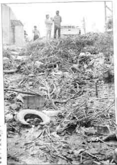
Ductos para aguas lluvias, como el de la precooperativa Velasco Ibarra, sudeño a La Playita, que desfogan en el estero Cobina, estarían transportando aguas residuales domésticas.
